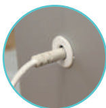
Zabezpieczone wyjście na kabel
